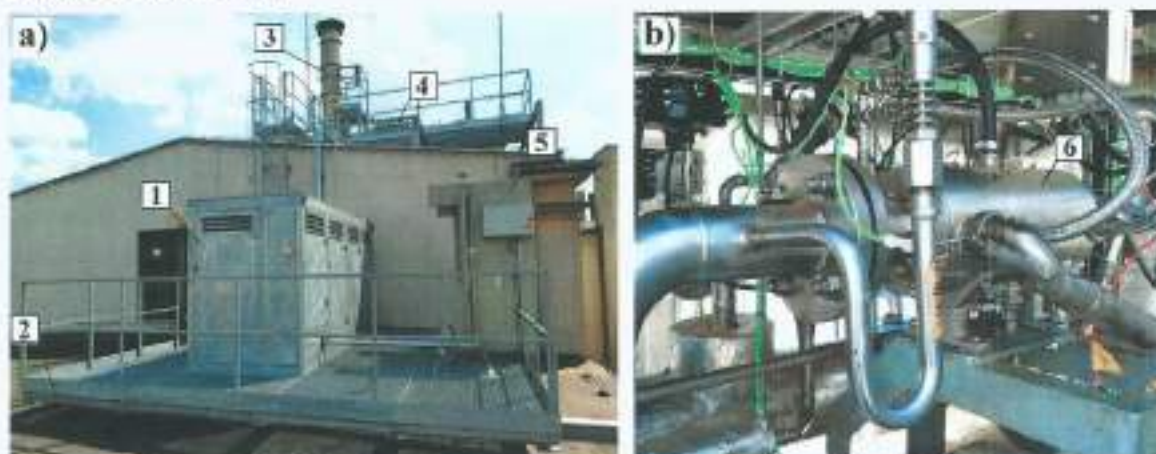
Rys. 3.40. Zdjęcie a) układu kogeneracyjnego ORC posadowionego na dachu firmy Grana, b) wnętrze kontenera z układem ORC: 1 – kontener z instalacją ORC, 2 – podest, 3 – źródło ciepła odpadowego, 4 – wymiennik ciepła (ekonomizer), 5 – układ odbioru ciepła ze skraplacza, 6 – mikroturbogenerator o mocy 10 kW e .
