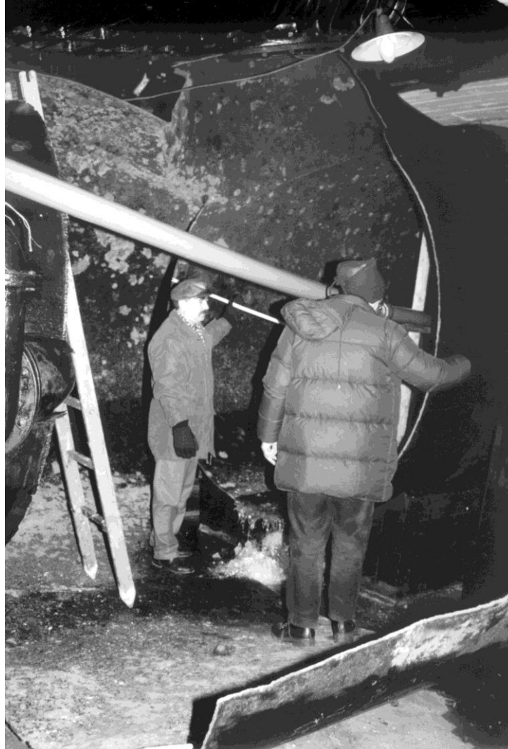
Rozerwanie rurociągu w Elektrowni Wodnej Łapino
