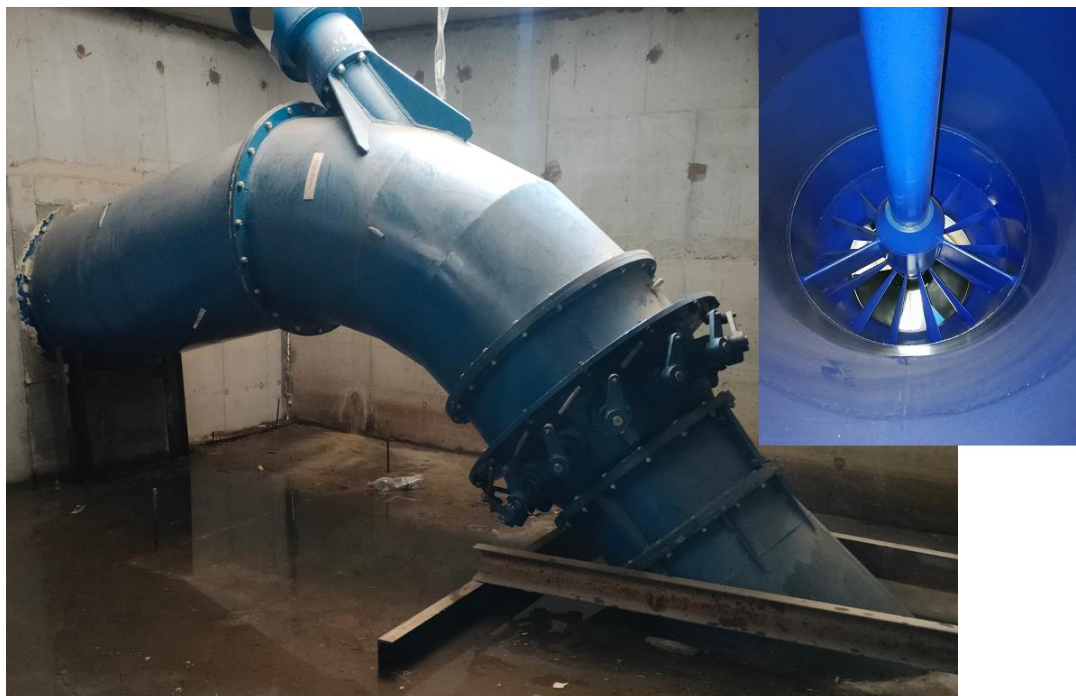
Rys.4.2. Prototyp turbiny Kaplana o mocy ~30 kW zainstalowanej w Elektrowni Wodnej Żagań-Papiernia.
