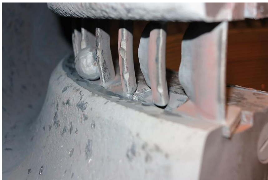
Rys. 21. Widok na uszkodzone łopatki promieniowe stopnia promieniowego we wrębach w korpusie wewnętrznym. Na grafice występuje „zmielone” pióro łopatki kierowniczej w postaci kuli.
